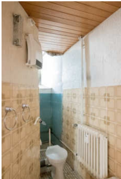
Bad (vor Sanierung)
